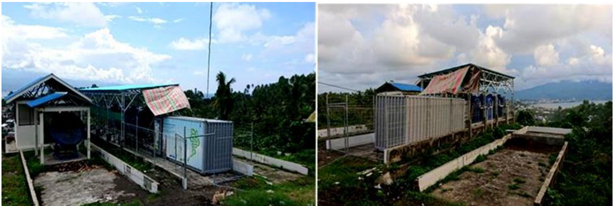
國外場域示意圖-印尼北蘇拉維西省建置的「二階段生物氫烷生產示範和培訓發電站」
